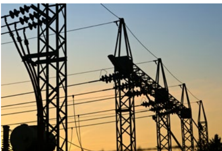
Transformatorstation i Birkerød
